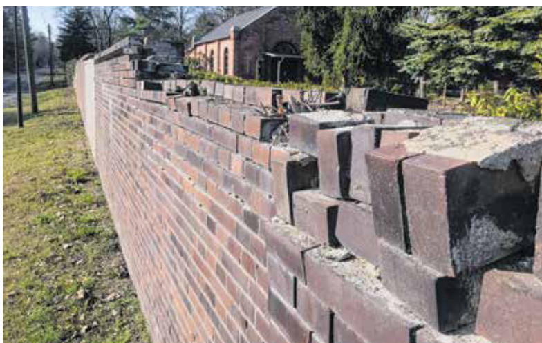
Marode: die Mauer am Friedhof in Fürstenwalde-Süd muss ersetzt, saniert oder abgerissen werden. Foto: Joachim Eggers
